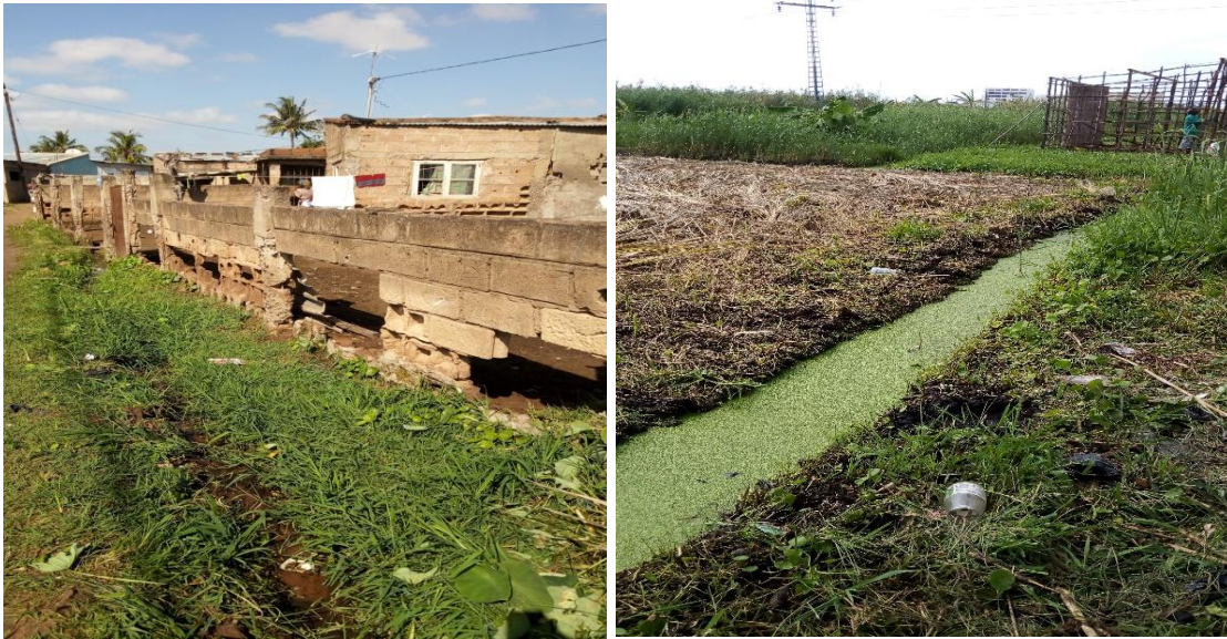
Figura 4.2. Parede em destruição e pequena vala com eutrofização.
