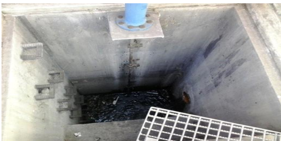
Figura nº15: Entrada do Esgoto Bruto, Composta por Grades Estáticas
