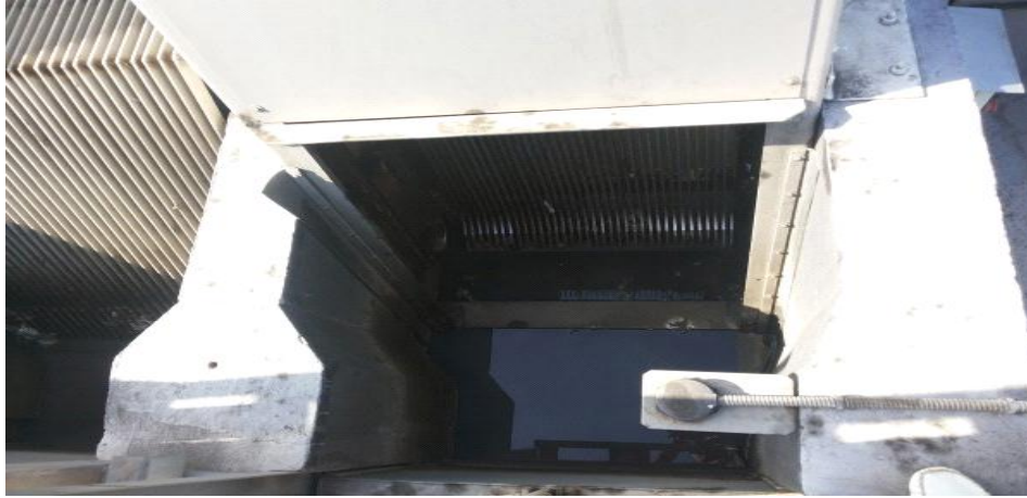
Figura nº16: Grelhas Mecânicas, (pré-tratamento complementar)
