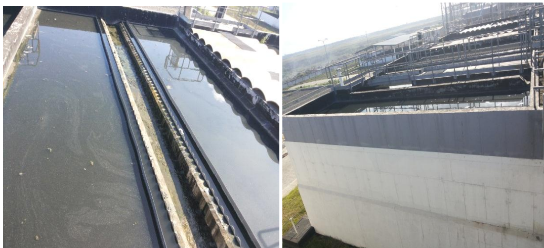
Figura nº18: Reactor Anaeróbico de Fluxo Ascendente
