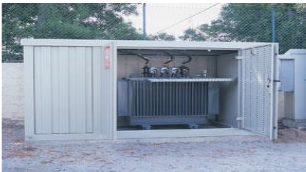
Figura 1: Posto de transformação (J.P. Dedieu, 2015)
