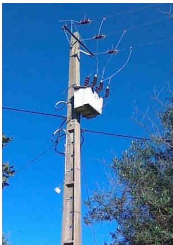
Figura 2: Vista geral de um PT do tipo A. tipo AS.
