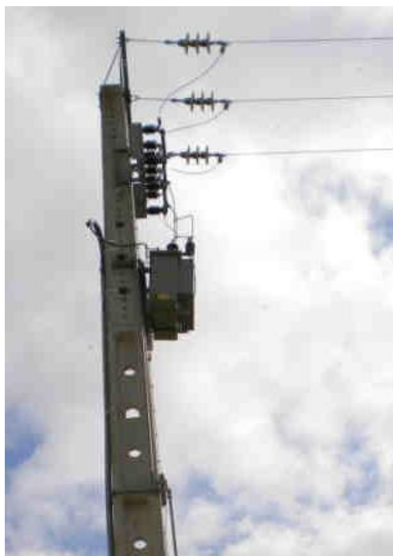
Figura 3: Vista geral de um PT do tipo AS.
