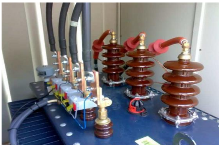
Figura 8: Transformador de intensidade montados do lado de BT
