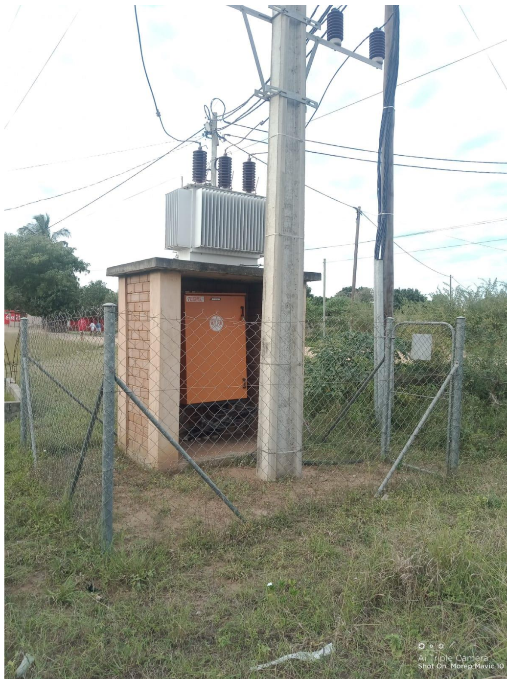
Figura 8-8: Posto de transformação N°139R
