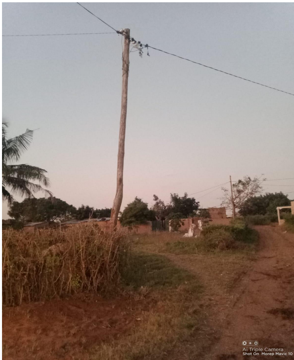
Figura 9-9: Postes de apoio
