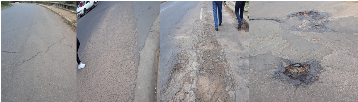
Figura 2- Representação de Pavimentos degradados (fonte: tirada durante aos trabalhos de manutenção de rotina, Município de Maputo)
