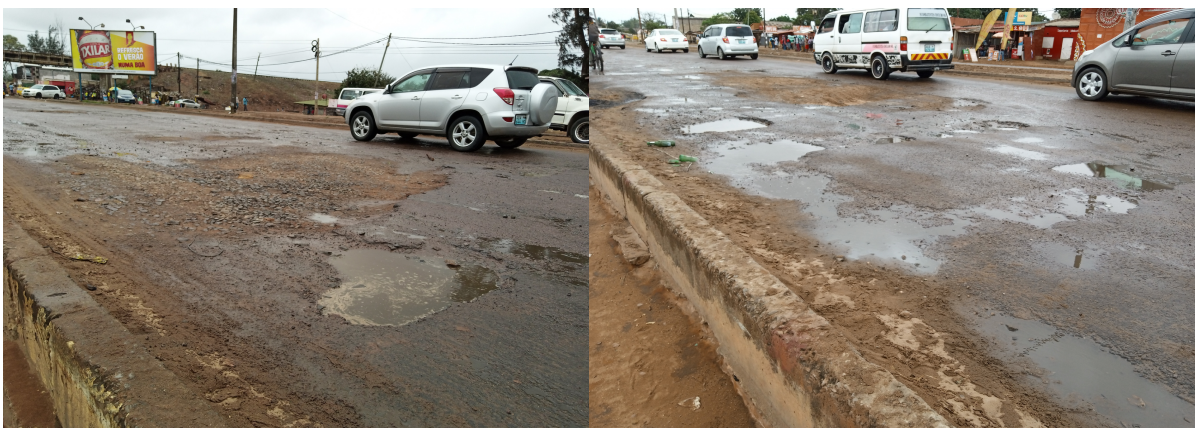
Figura 1- Representação da situação antes do tapamento dos buracos de alguns troços da Av. Julius Nyerere
