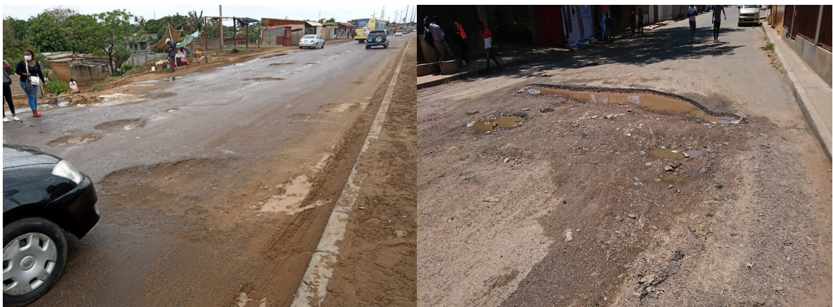
Figura 12- Representação da patologia tipo covas (Av. Julius Neyere)
