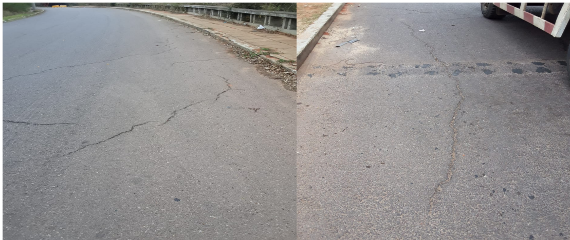
Figura 6- Representação de fendas parabólicas (estrada que liga ponte Alcantra)
