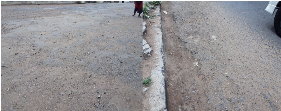
Figura 10- Representação da patologia tipo desagregação superficial (fonte: foto tirada no Município de Maputo)
