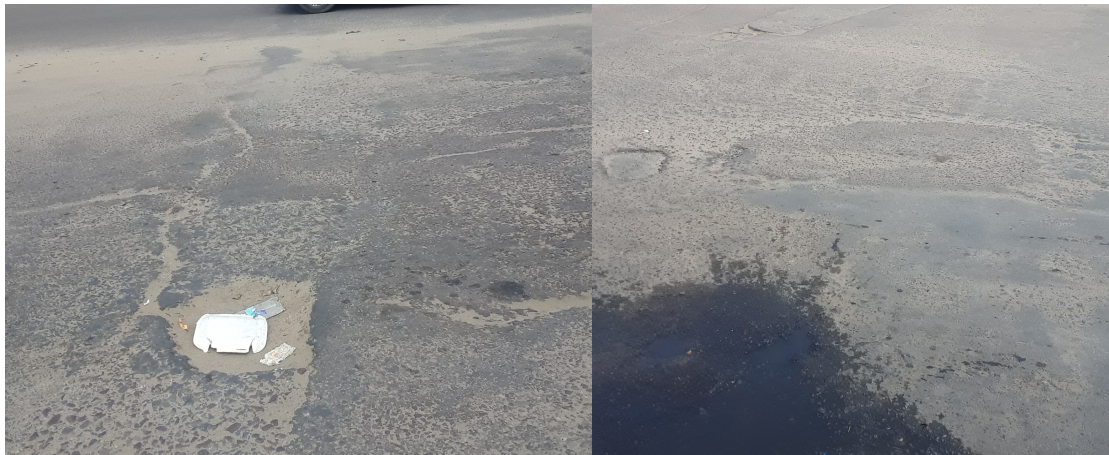
Figura 14- Representação da patologia do tipo subida de finos (foto tirada no Município de Maputo)
