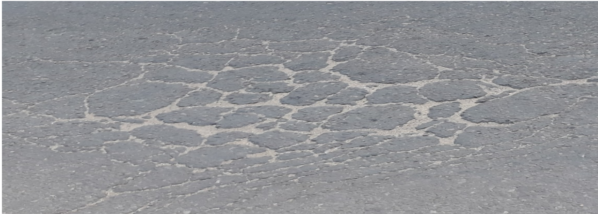
Figura 8- Representação da patologia tipo pele de crocodilo (foto tirada no Município de Maputo)
