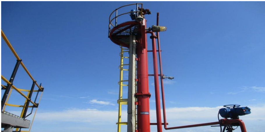
Figura 7: Canhão de combate a incêndio
