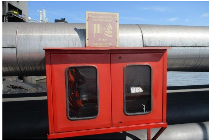
Figura 5: Hidrantes de combate a incêndio
