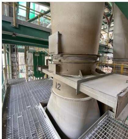
Figura 12: Reactor de Venturi (Fonte: Aatoria própria – Mozal CTG 3).
