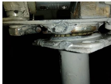
Figura 4.2 – Rolamento fixado no topo da torre
