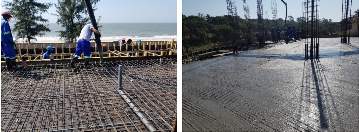
Figura 21- Betonagem da laje com auxílio de uma manga flexível (à esquerda) e medição da profundidade do betão e alisamento da sua superfície (à direita)
