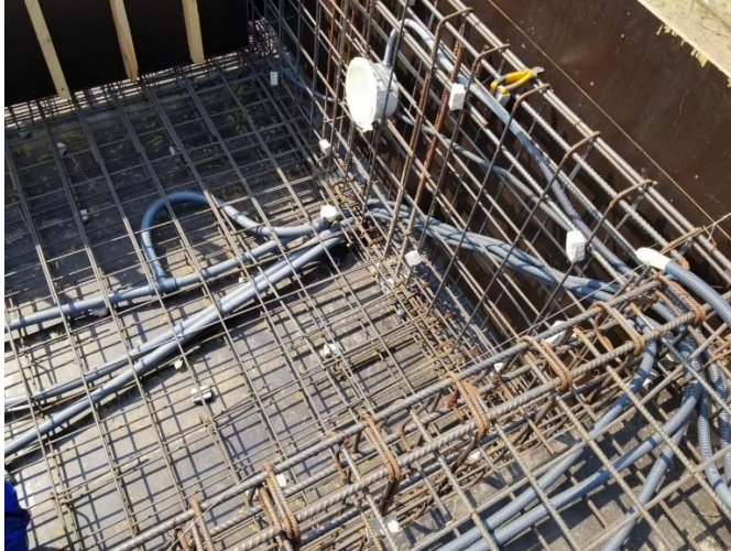
Figura 24- Vista geral das tubagens da piscina
