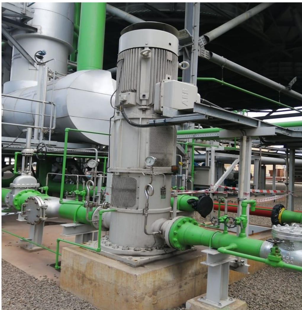
Figura 3.8: Conjunto motor-bomba. Fonte: [EDM].
