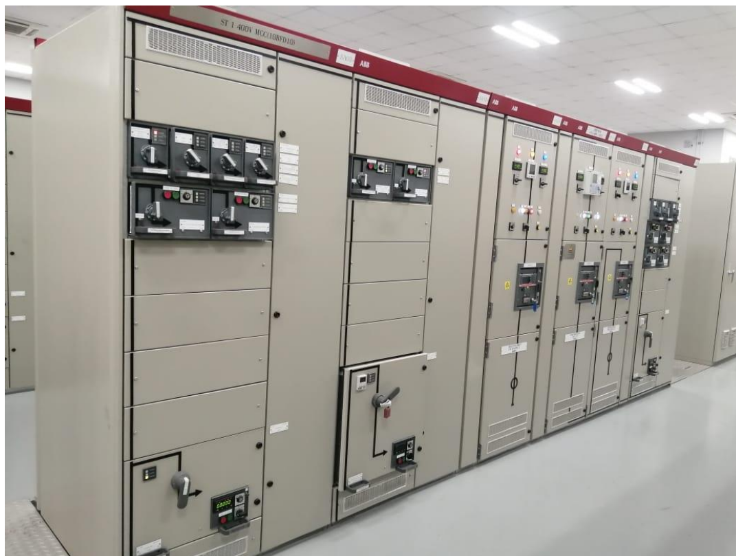
Figura 3.3: Centro de controlo dos motores. Fonte: [EDM].
