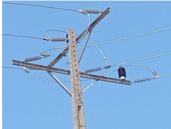
Figura 9. Condutores de alumínio
