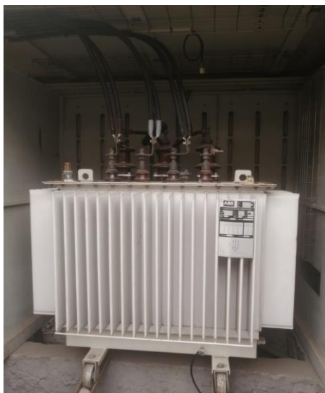
Figura 12. Transformador de distribuição
