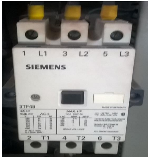
Figura 15: Contactor 3TF48 instalado no banco (Fonte: O Autor)
