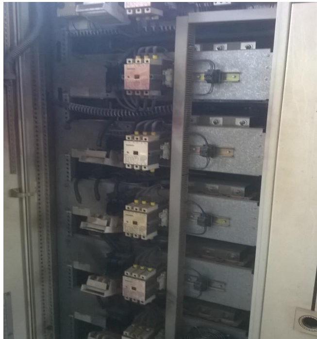
Figura 11: Banco de capacitor da SE1.2 – CFM-Sul (Fonte: O Autor)
