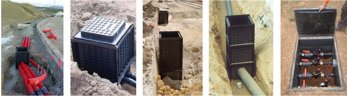
Figura 5.1: Caixas de inspeção na rede de distribuição subterrânea
