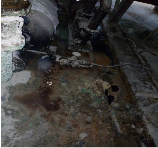
Derrame de afluentes resíduos de sabão
