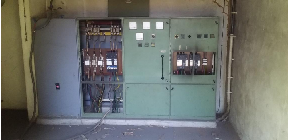
Figura 27: Armário do PT do DEEL. Fonte: (Autor, 2023)
