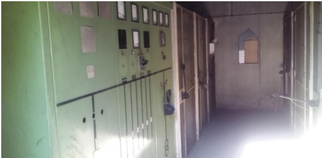
Figura 26: Armário do PT central. Fonte: (Autor, 2023)
