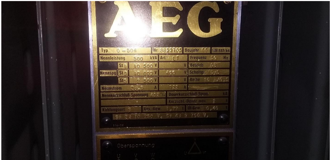
Figura 90: Chapa característica do transformador do DEEL. Fonte: (Autor, 2023)
