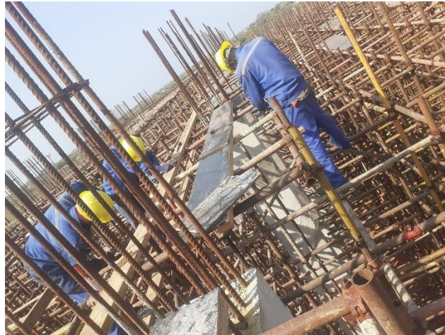
Figura 26. Alinhamento das cotas das bases das vigas
