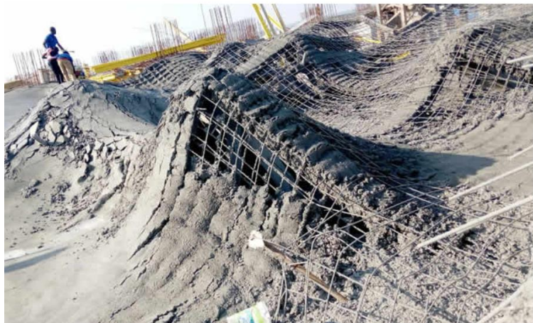
Figura 5. Queda de escoras em edifício na cidade de Maputo por conta de montagem inadequada (fonte: Cartamz.com) [8]
