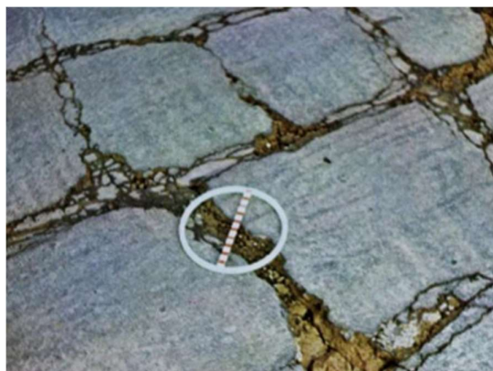
Figura 6. Trincas em blocos (Fonte: Norma DNIT 005/2003 - TER 2003)
