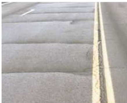
Figura 9. Trincas por reflexão em juntas (Fonte: FHWA 1993)
