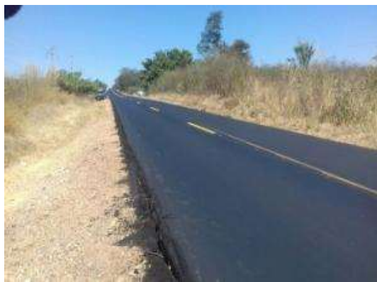
Figura 18. Desnível entre pista de rolamento e acostamento não pavimentado (Fonte: Arquivo do DER/SP)
