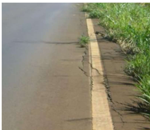
Figura 7. Trincas nos bordos (Fonte: Arquivo do DER/SP)
