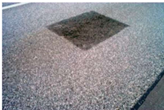
Figura 11. Remendo 'bem' executado (Fonte: Bernucci et al., 2007)
