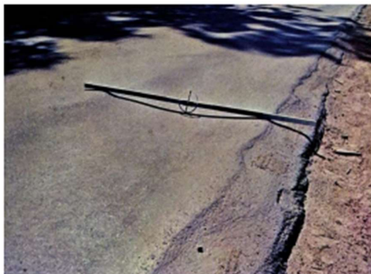
Figura 13. Deformação Permanente nas trilhas de roda (Fonte: Norma DNIT 005/2003 – TER 2003)
