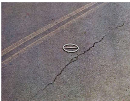
Figura 8. Trinca longitudinal fora das trilhas de roda (Fonte: Norma DNIT 005/2003 - TER 2003)
