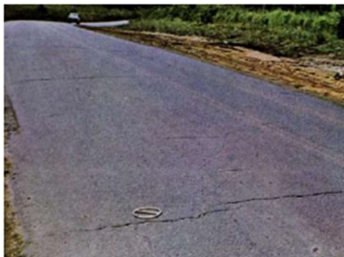
Figura 10. Trinca transversal (Fonte: Norma DNIT 005/2003 - TER 2003)
