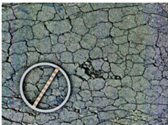
Figura 5. Trincas por fadiga (Fonte: Norma DNIT 005/2003 - TER 2003)
