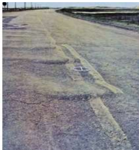
Figura 14. Corrugação ou Escorregamento (Fonte: Norma DNIT 005/2003 – TER 2003)
