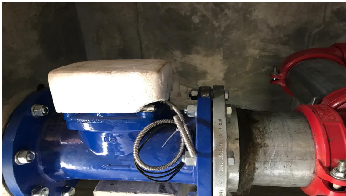
Figura A5.2-6: Fotografia de conduta principal de drenagem e contador de pulso instalado no Emissário da Higest. (Fonte: O Autor, 2023)
