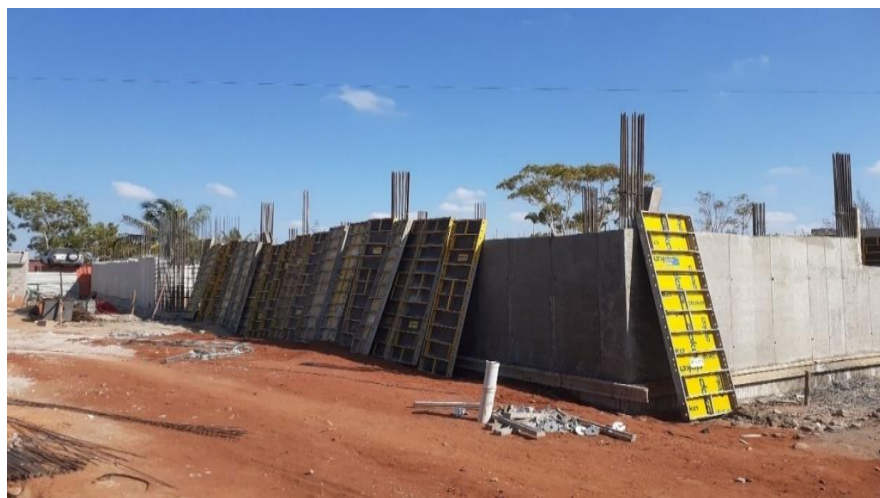
Figura: 24 Desconfrangem do muro(fonte- autor)
