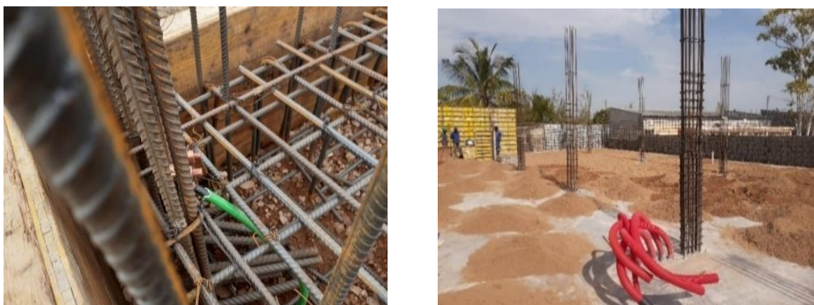
Figura: 47 Cabo de cobre ligados no pilar(fonte- autor)
