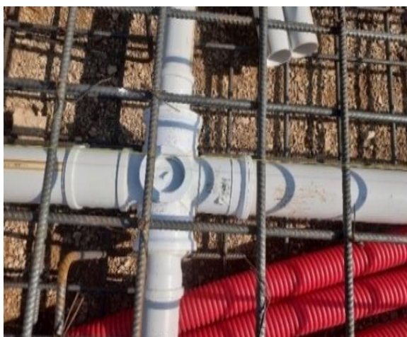
Figura: 45 Tubos fixado num distribuidor de saídas
