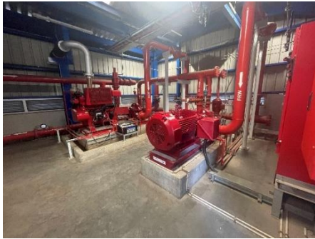
Figura 8: Bombas de combate ao incêndio. [autor]
