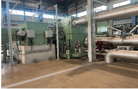
Figura 2: Turbina a Vapor. [autor]
