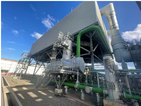
Figura 5: Condensador de Vapor. [autor]
