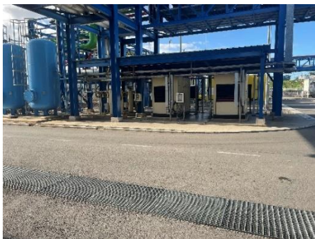
Figura 7: Compressores de ar. [autor]
