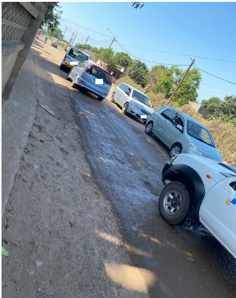
Figura 2: Estrada esburacada no bairro do Fomento. Autor - Maputo, 2023.
