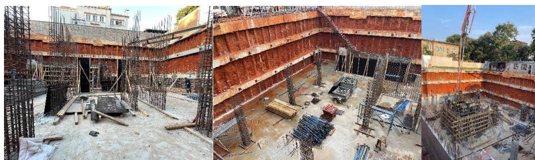
Figura 8: a) e b) Armaduras dos pilares e núcleo de escadas na vista frontal e superior; c) Betonagem dos pilares da cave no piso -2. (Fonte: Autora)
