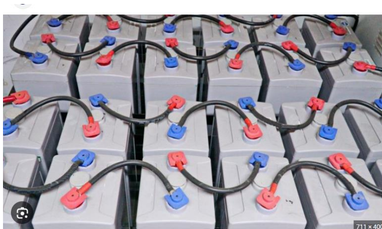
Figura 1 - banco de baterias
