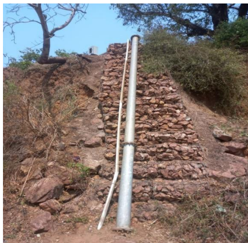
Figura 11. Tubulação Usada Para a Captação de Água na ETAG.
