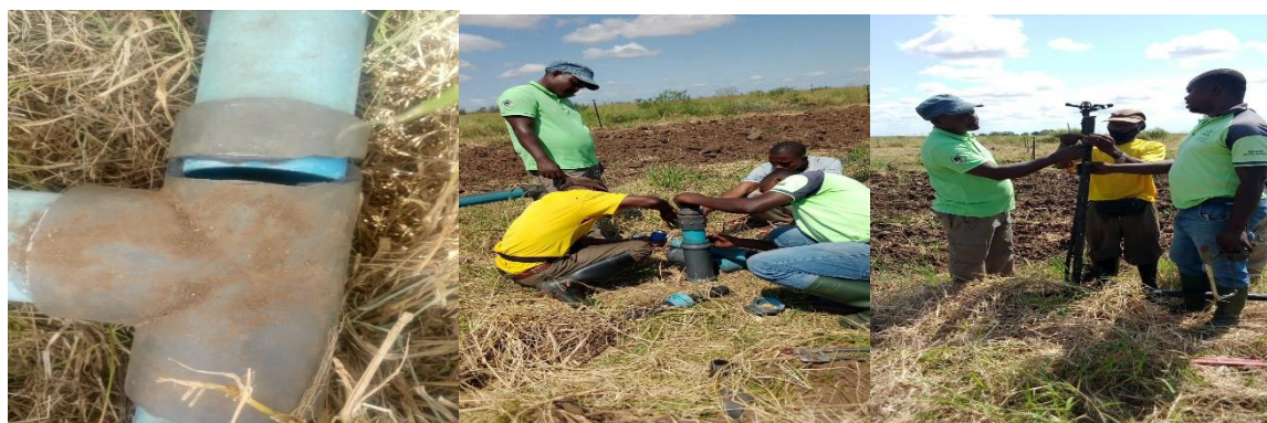
Figura 4: Tubo rompido e fases de reparação do sistema de irrigação por aspersão.
