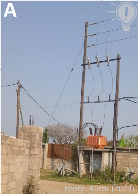
Imagem 73: PT de Energia
