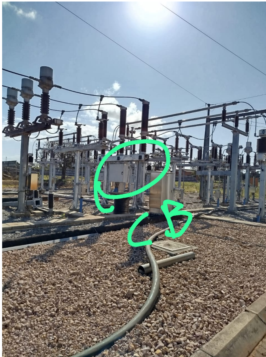
Figura 7: Subestação. Fonte: Autor
