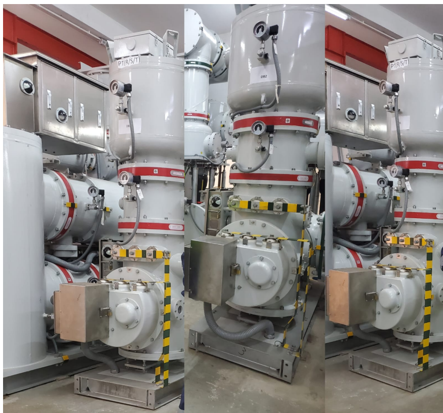
Figura 10: Subestação. Fonte: Autor
