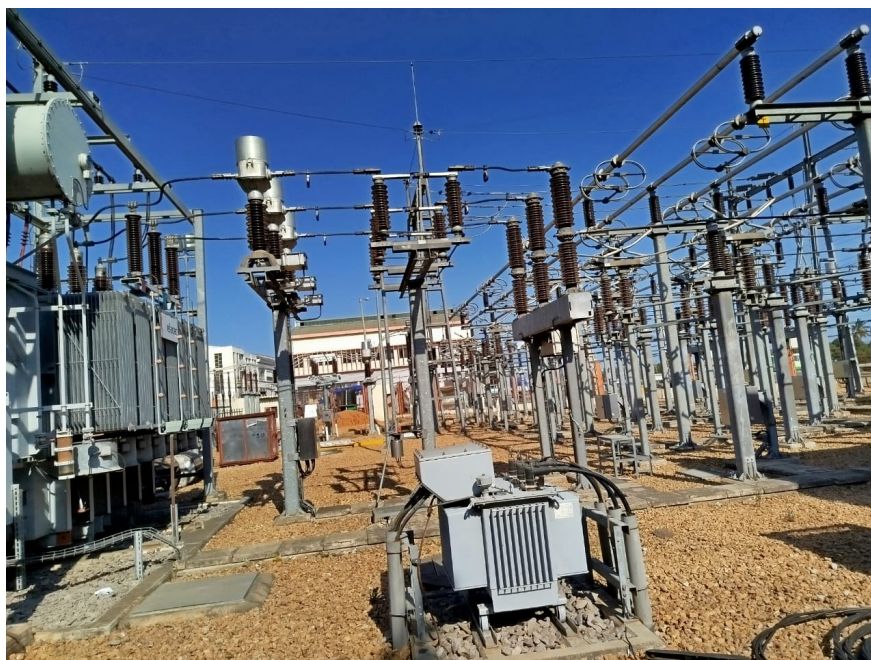
Figura 9: Subestação. Fonte: Autor
