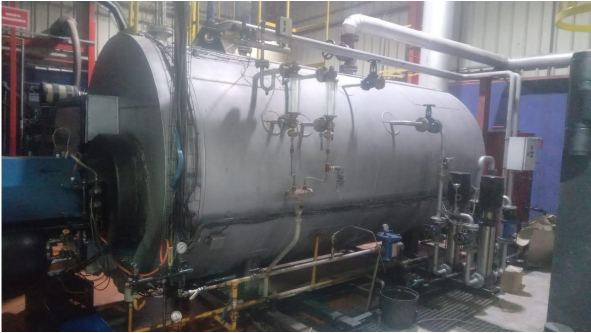
Figura 8: Vista lateral direita da caldeira. Uma bomba de água avariou.
