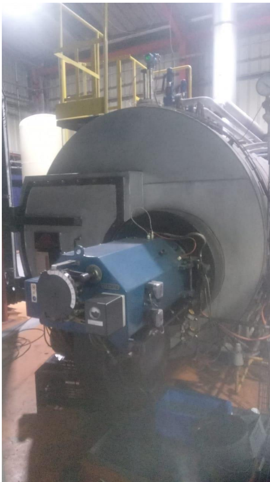
Figura 5: Vista Frontal da caldeira. O queimador tem falhas de ignição
