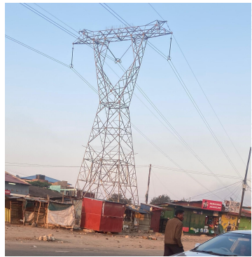
Poste de alta tensão no bairro de Malhamspene
