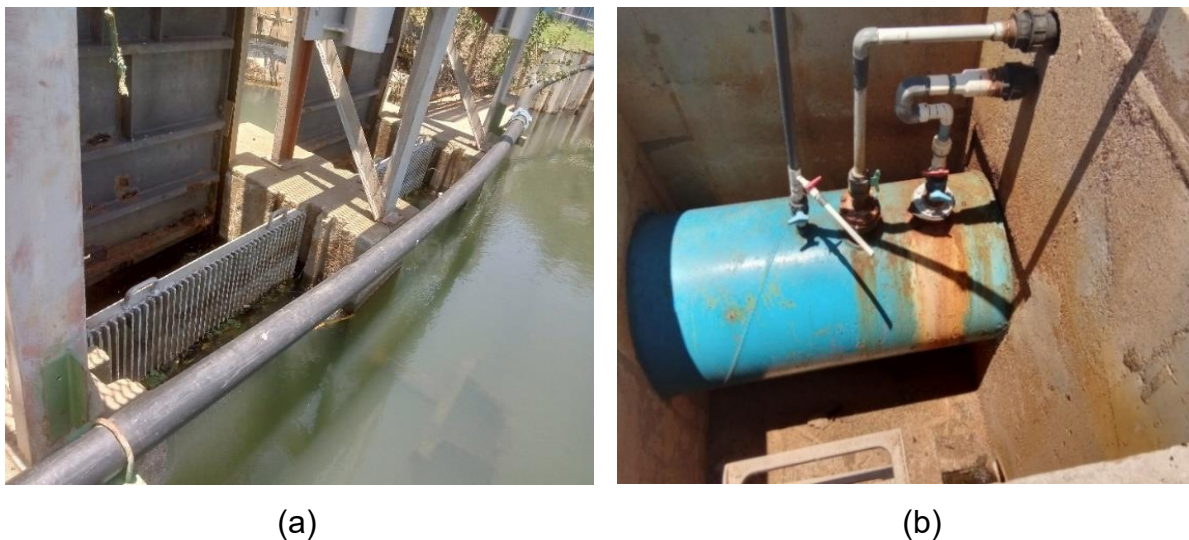
Figura 4: (a) Grades de retenção e (b) Pré-cloração
