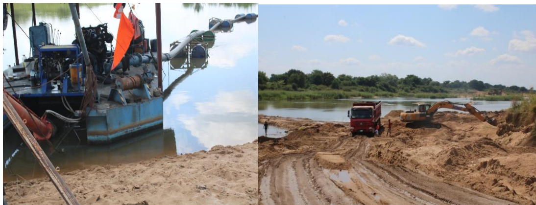
Figure 10 Exploração de inertes na Bacia do Rio Incomáti.
