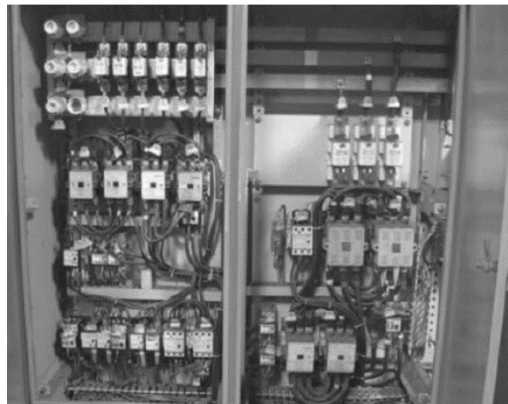
Figura 14: Quadro Geral de Baixa Tensão (QGBT)
