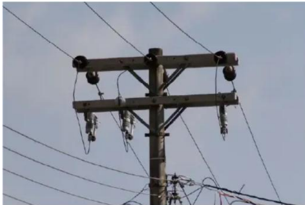
Figura 1 Rede de Distribuição aérea
