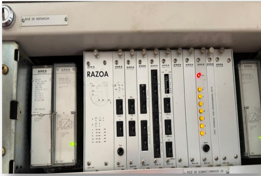
Figura 30: Relé da ABB
