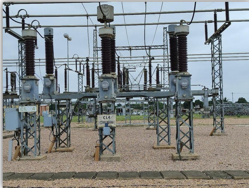
Figura A7: 1-10: Painel de linha da CL4 visto da SE Infulene
