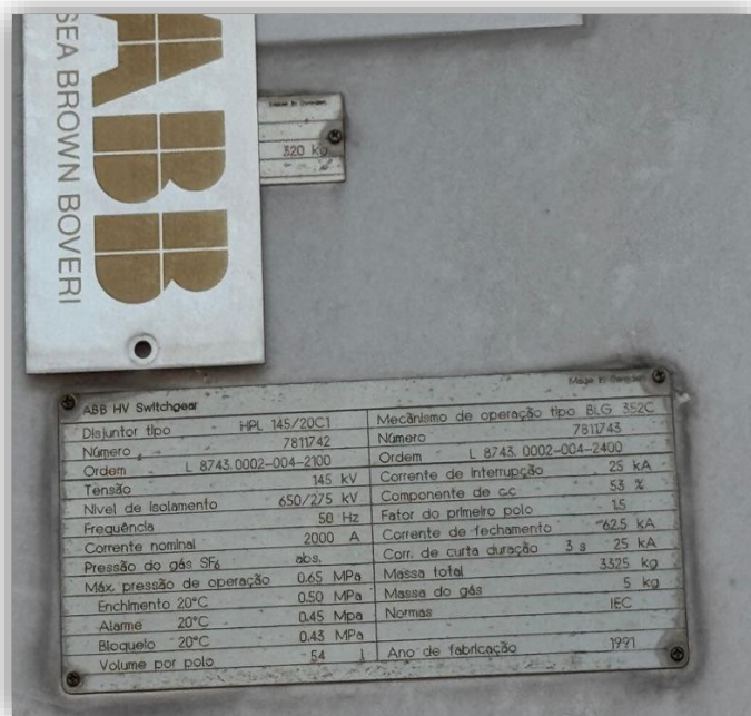
Figura A7: 2-10: Chapa característica do disjuntor da CL5 da SE Corumana
