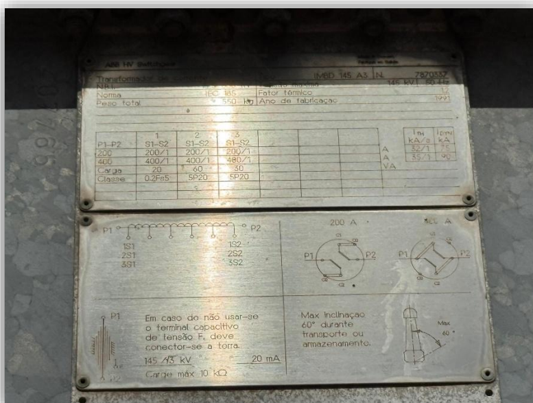
Figura A7: 6-11: Chapa caracterstica do transformador de corrente SE Corumana
