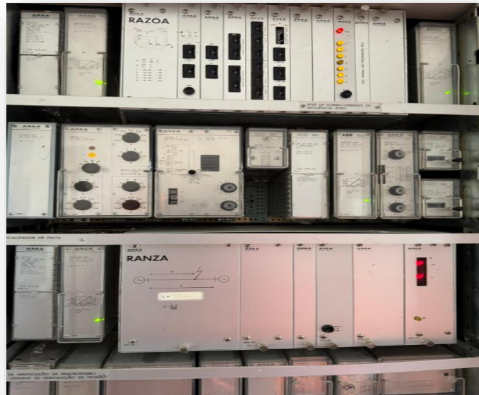
Figura 28: Relé da ABB
