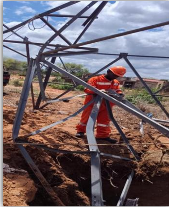
Figura 33: Elementos estruturais empenados da torre da CL4
