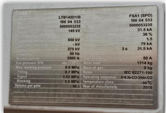
Figura A7: 3-10: Chapa característica do disjuntor da CL4 da SE Corumana
