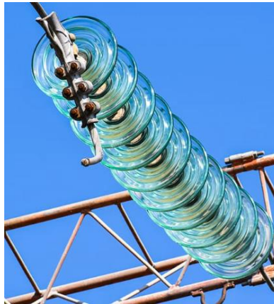
Figura 12: Isolador de Vidro em uma linha de transmissão
