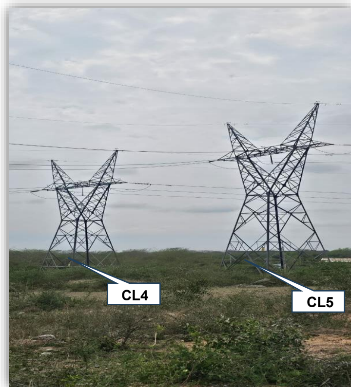
Figura A6: 1-9: Torre de transmissão da linha CL4 e CL5 a partir da SE Corumana
