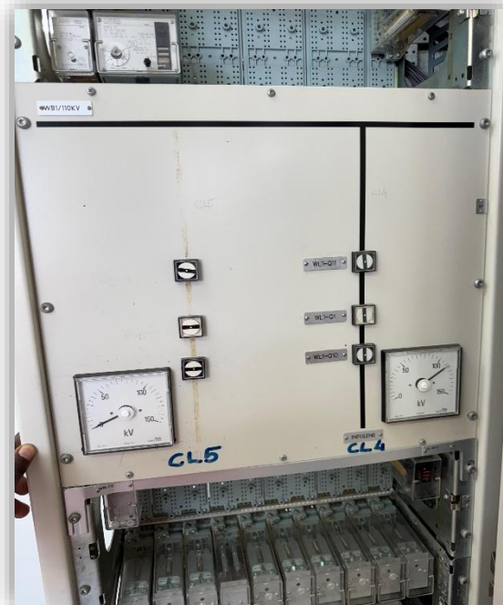
Figura A7: 5-11: Painel de controle de barramento na SE Corumana
