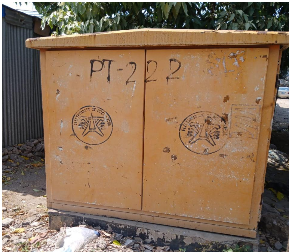
Figura A2-2: Posto de transformação em estudo. (Fonte: Autor, 2025)
