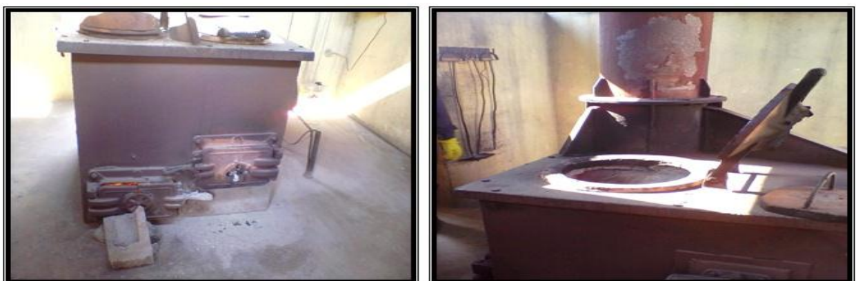
Figura nº 16: Incinerador Utilizado para Tratamento Térmico dos RSS Fonte: Autor, 2015
