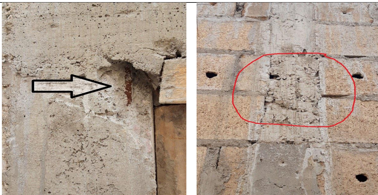
Figura 42 - Segregação do betão depois de betonado
