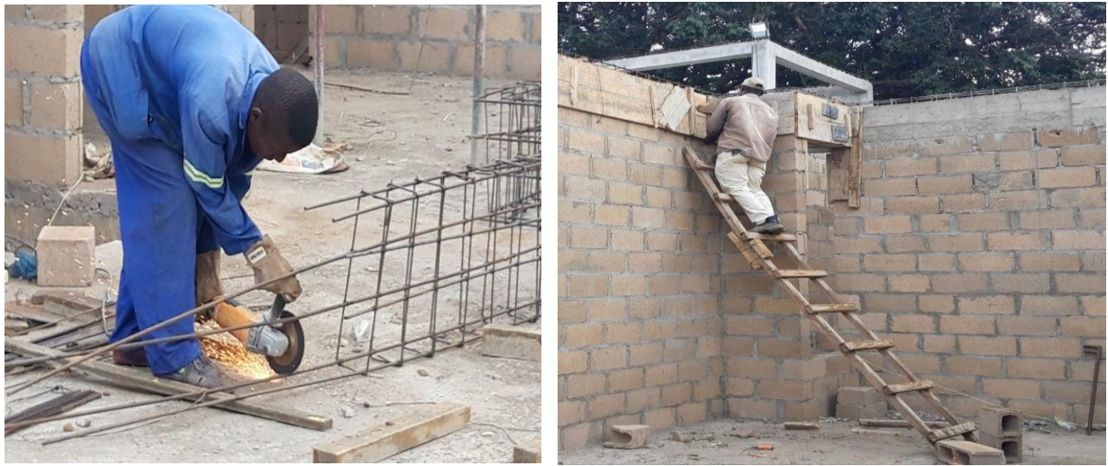
Figura 39 - Trabalhadores sem equipamentos adequados
