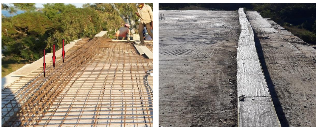
Figura 47 - Viga deformada antes e depois de betonada
