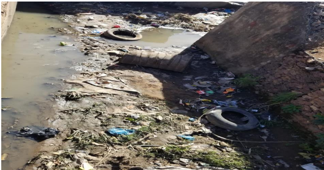
Figura 4.1: Estado de conservação da vala de drenagem
