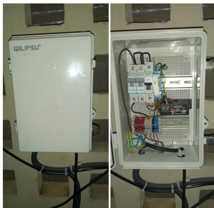
Figura 4.2: Caixa do circuito da unidade de controlo da bomba de pressão. Fonte: Autor
