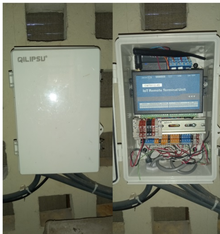
Figura 4.1: Caixa do circuito de controlo do sistema. Fonte: Autor
