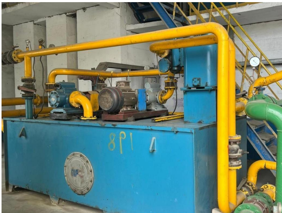
Figura 17: Posto de óleo do Redutor Principal (Fonte: Autor)
