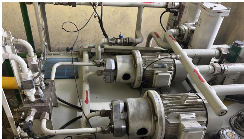
Figura 28: Caixa de posto de óleo com capacidade de 210L de lubrificação (Fonte: Autor)
