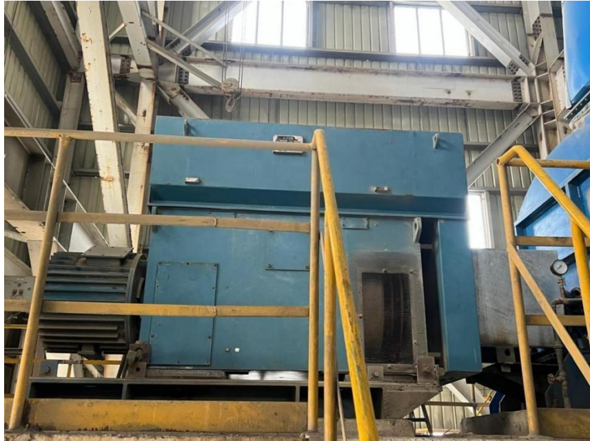
Figura 19: Motor do Exaustor Principal (Fonte: Autor)
