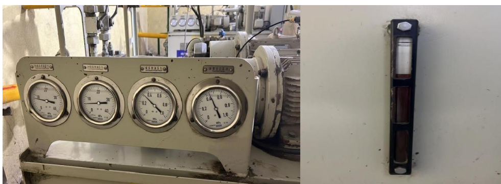
Figura 30: Manômetros que controla a pressão e o níveis de óleo (Fonte: Autor)
