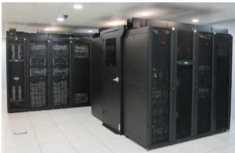
Figura 2.32: Sala de Equipamentos. Fonte: (PANDUIT, SALA DE MÁQUINAS, 2010)
