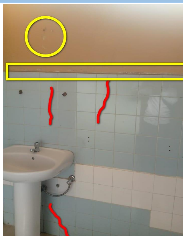
M0.17) Eflorescências; D0.4) destacamento da pintura; F0.9) Múltiplas fissuras nas tijoleiras da wc.
