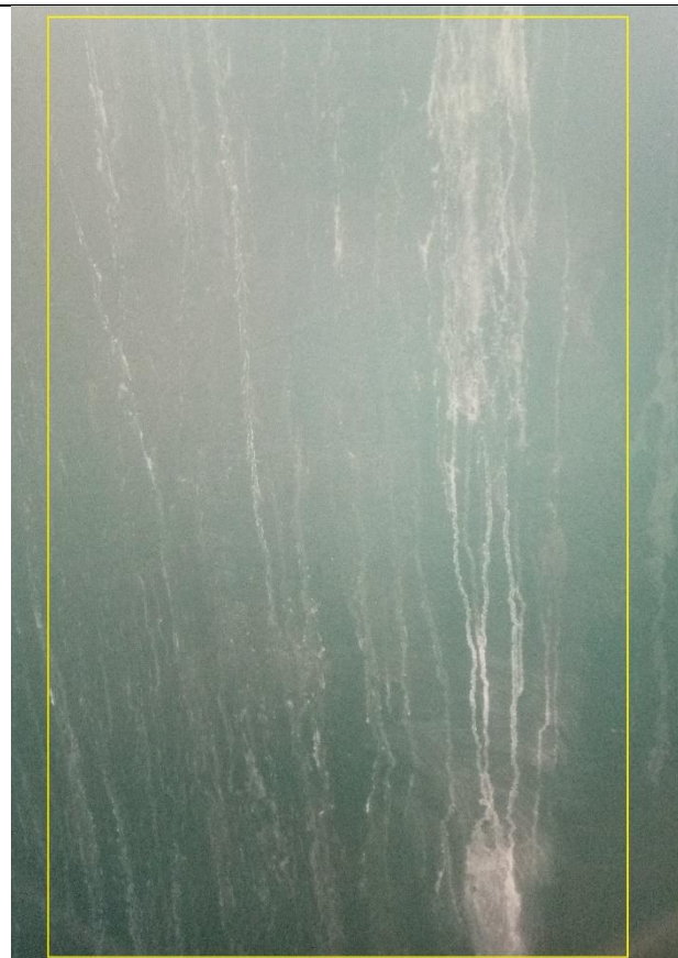
M0.3) Eflorescências na parede adjacente a escada do rés do chão; M0.4) Manchas brancas escorrendo na superfície da parede, eflorescência.
