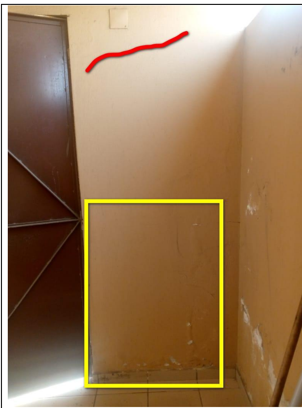
D2.3) Destacamento da pintura; F2.2) Fissura diagonal
