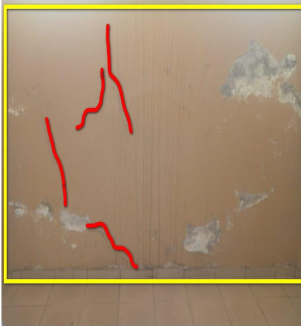
F2.1) Múltiplas fissuras; D2.1) Destacamento da pintura; M2.1) Manchas de escurimento de água, Eflorescência.
