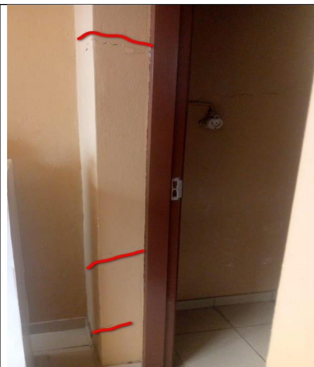
F1.2) Múltiplas Fissuras horizontais na parede junto à porta da despensa.
