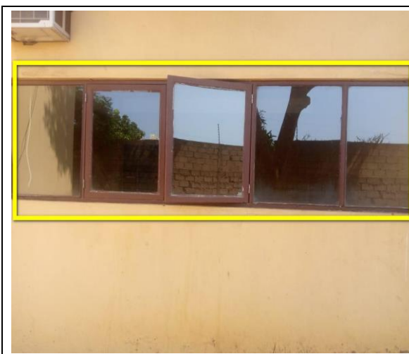
De.12) Destacamento da pintura na janela do escritório 3
