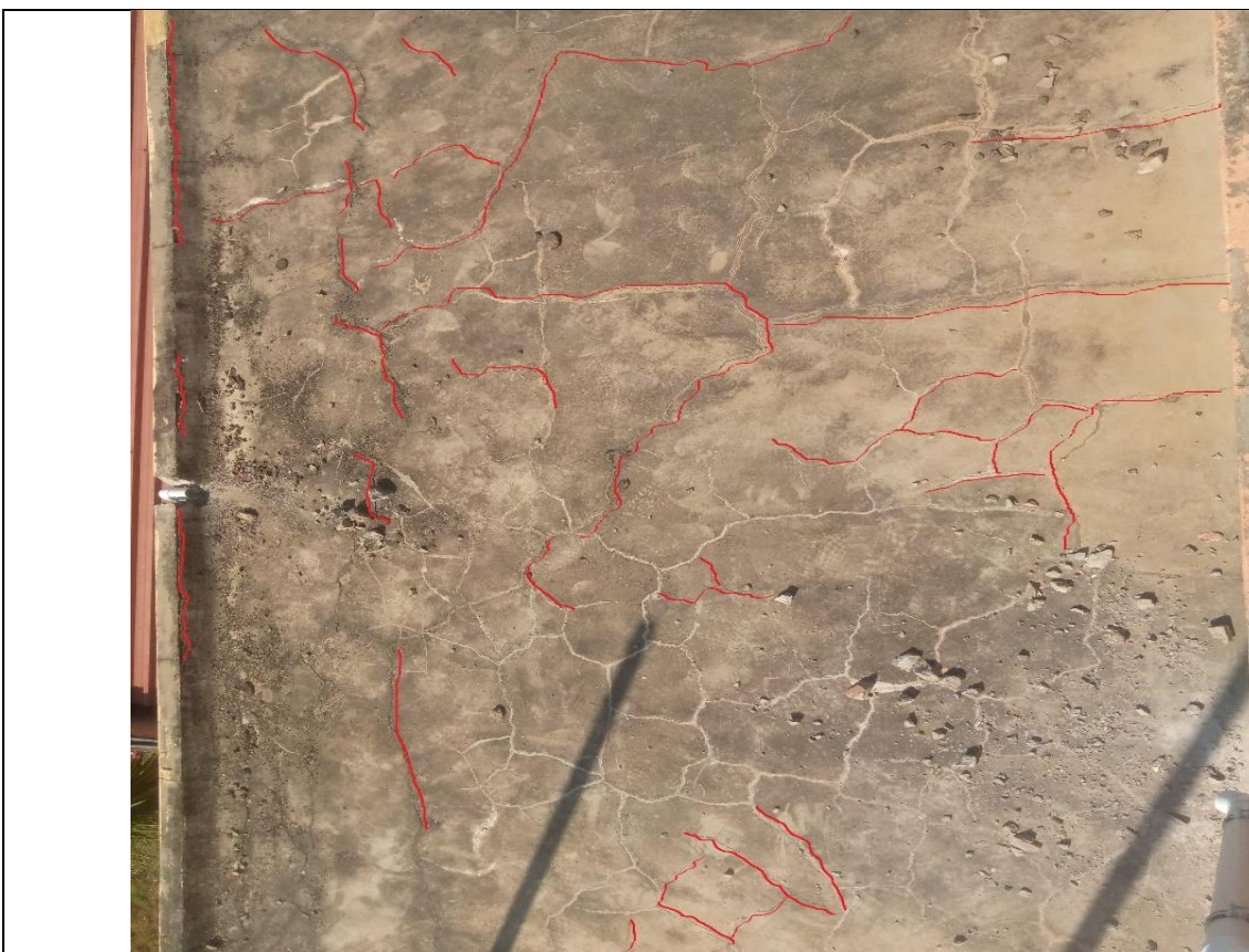
F2.4) Fissuras dispersas na laje de cobertura; G2.5) Presença de fungos
