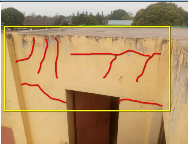
D2.4) Destacamento da pintura; G2.1) Presença de fungos; F2.4) Fissuras dispersas na parede.
