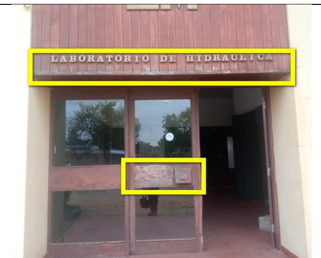
De.9) Destacamento da pintura na porta
