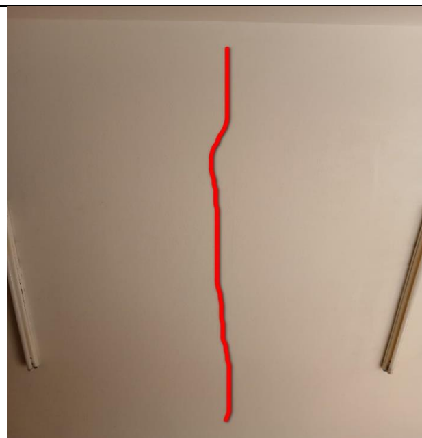
F0.8) Fissura transversal na laje do escritório 5
