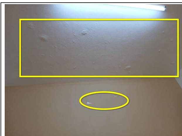
M0.6) Bolhas de humidade na laje de cobertura e parede do escritório 1
