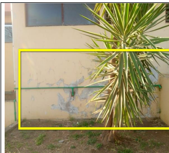
De.8) Destacamento da pintura na fachada frontal das casas de banho, vista do exterior
