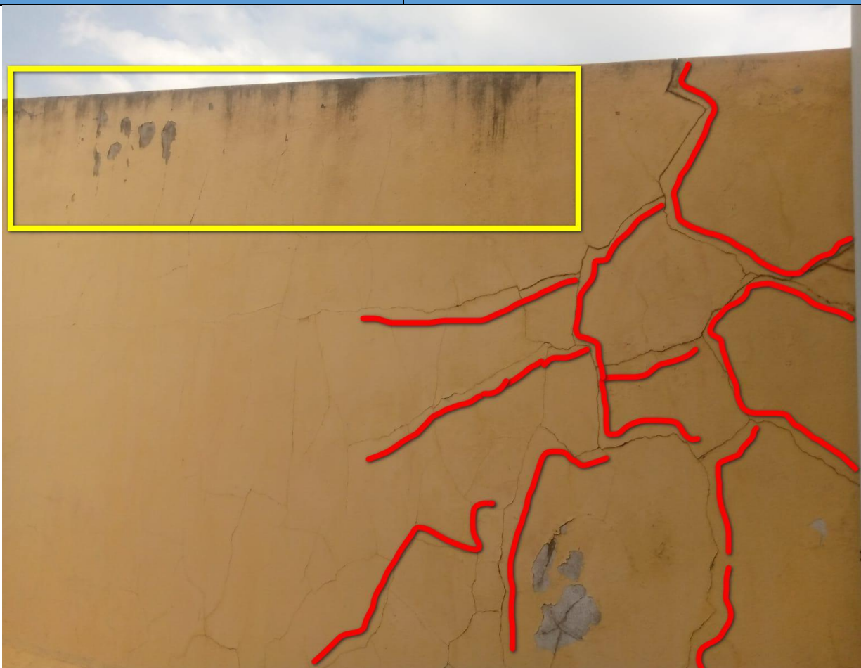
De.14) Destacamento da pintura; Fe.11) Fissuras dispersas na parede; Ge.2) Presença de Fungos na parte superior da parede.
