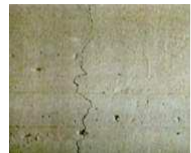
Figura 14: Fissura por retracção de betão (ERTHAL, 2020)
