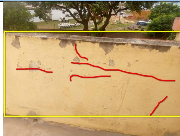
D2.5) Destacamento da pintura; G2.2) Presença de fungos; F2.5) Fissuras dispersas na parede.
