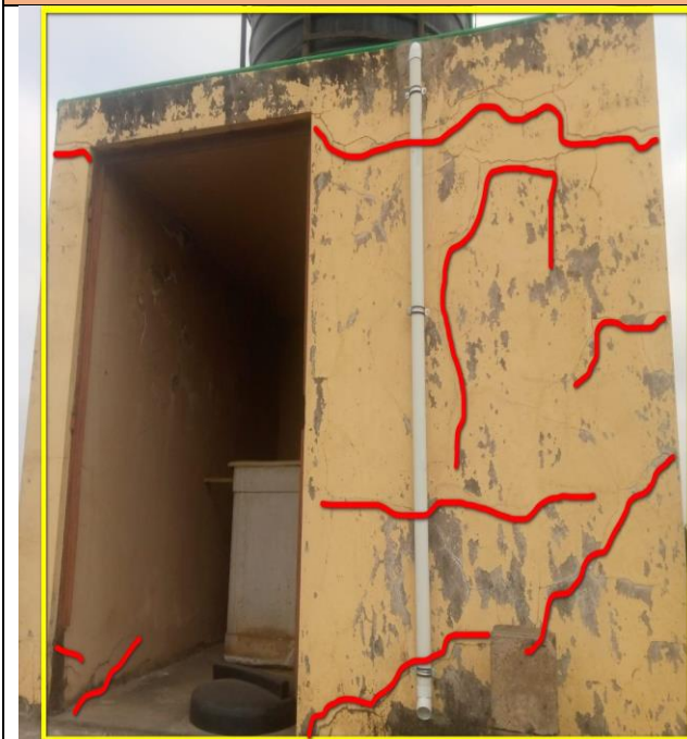
D3.1) Destacamento da pintura; G3.1) Presença de fungos; F3.1) Fissuras dispersas na parede.
