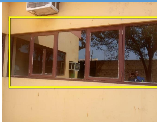
De.11) Destacamento da pintura na janela do escritório 4
