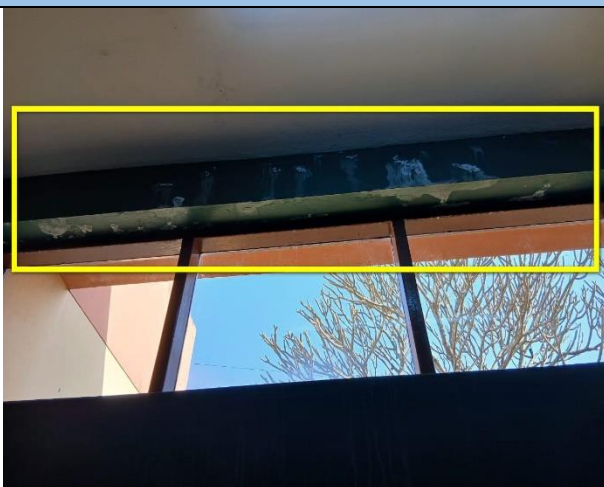
M0.5) Eflorescência no lintel da janela do corredor dos escritórios
