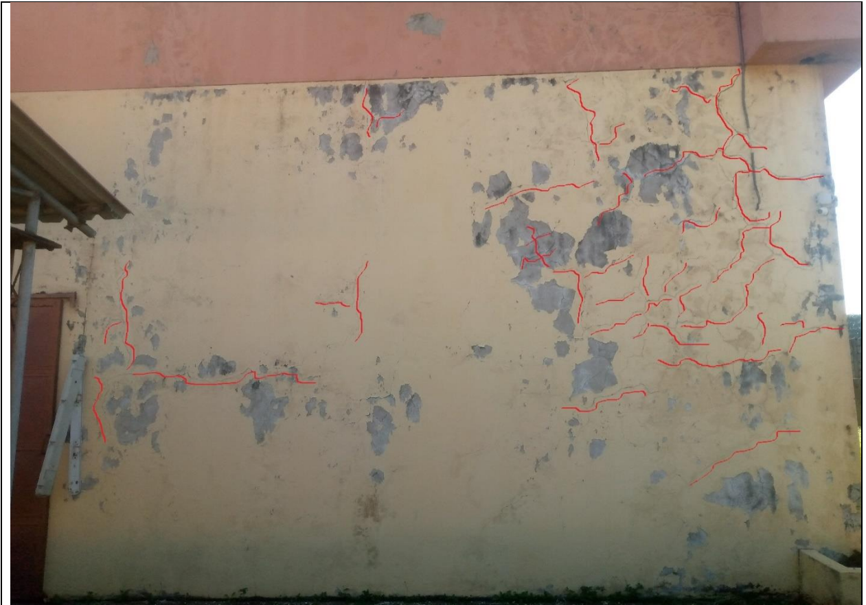
Me.2) Manchas de humidade na fachada lateral direita; Fe.2) Fissuras dispersas; De.2) Destacamento da pintura.
