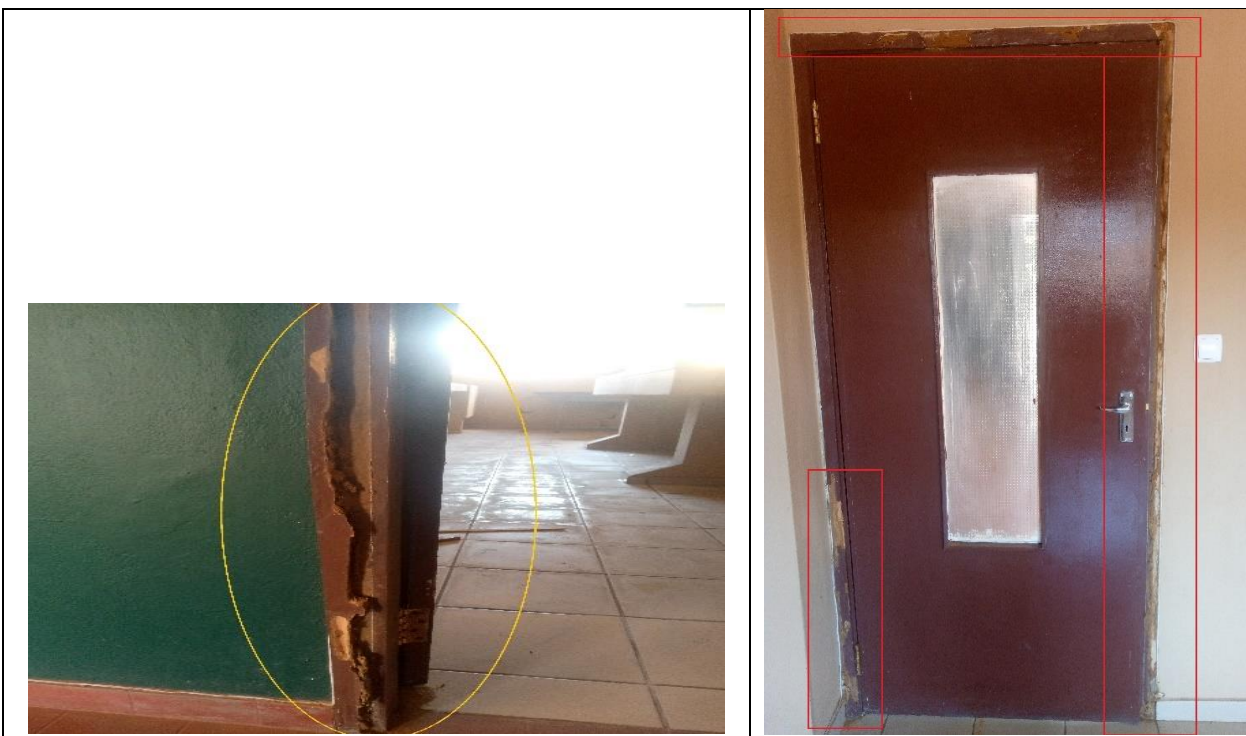
T0.1) Deterioração do aro de madeira nas portas e destacamento da pintura.
