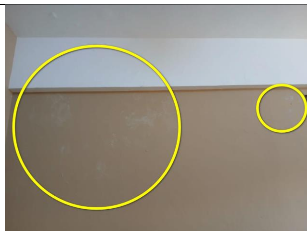
M0.7) Eflorescências na parede do escritório 1
