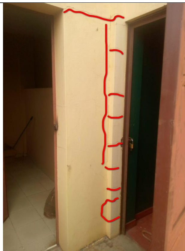
F2.3) Múltiplas fissuras no pilar
