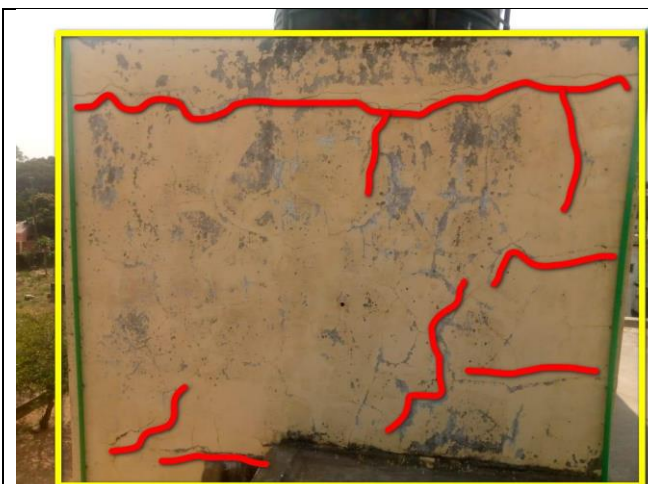
D3.2) Destacamento da pintura; G3.3) Presença de fungos; F3.3) Fissuras dispersas.
