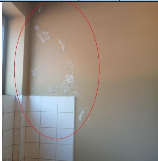
M1.2) Eflorescência na parede da sala de refeições "copa".
