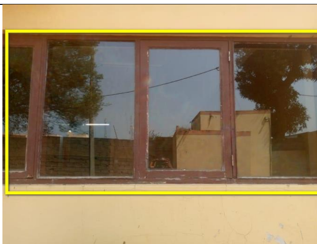
De.13) Destacamento da pintura na janela do escritório 2
