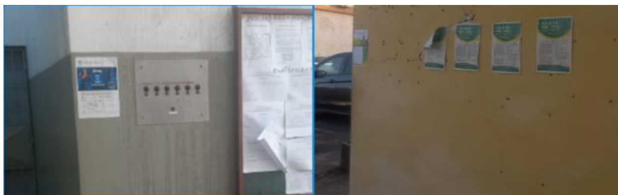
Figura 16: Comunicados colocados em locais impróprios - nas paredes
